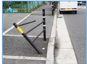
【柵が倒れている】
